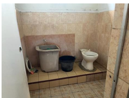
Gambar 9. Toilet yang belum memenuhi standar untuk pengguna lansia kursi roda. (Dokumentasi Penulis, 2023)
