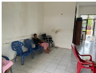
Gambar 6. Lantai dengan kondisi licin (Dokumentasi Penulis, 2023)
