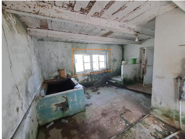
Gambar 6 Kerusakan Area Kamar Mandi
