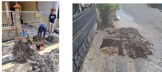
Gambar 4. Pengecekan Titik Bocor di DMA Babatan Mukti.
